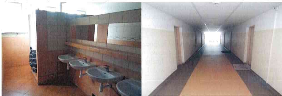
Ryc. 2. Łazienka i korytarz w Bursie Szkolnej nr 1 w Łomży (budynek B) po wykonaniu zaleceń, fot. PSSE w Łomży.
