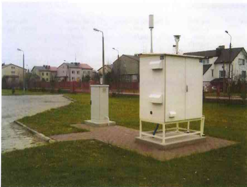
Fot. 1. Zmodernizowany w 2010 roku Punkt monitoringu zanieczyszczenia powietrza atmosferycznego przy ul. Sikorskiego 94/98 w Łomży
